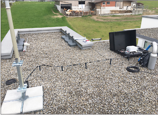
Speiseleitung mittels Hühnerleiter
